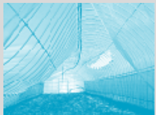
(左: 強風により2連棟ハウスのうち1棟が倒壊の被害にあう)
